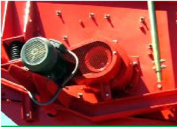
Antiguo sistema de instalación del motor.
